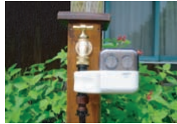
立水栓に設置
